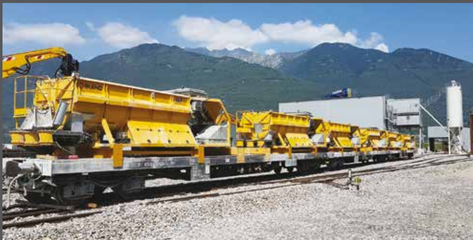
9. I miscelatori vengono portati su carri a pianale e caricati sotto l'impianto con 7,5 m 3 di calcestruzzo per 300 m sino all'imbocco della galleria
